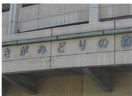
球場壁面劣化
