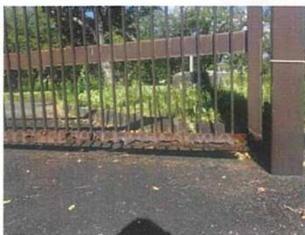
南・西駐車場門扉腐食
