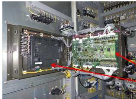
発電基盤を開いた内部 操作パネル(左)と制御盤(右)
