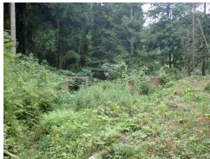
② 既設ダム堆積状況
