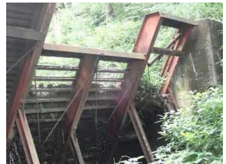
③ 腐食状況
