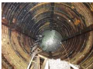
① 1号集水井鋼材腐食状況
