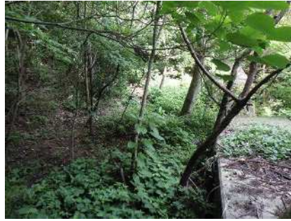
②治山ダム土砂堆積状況
