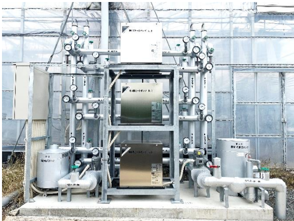
【地中熱ヒートポンプ】
