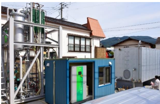
【温泉発電システムの実証試験環境】
