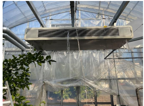
【ハウス内ファンコイルユニット】
