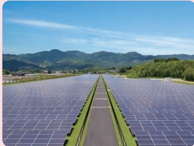
吉野ヶ里メガソーラー発電所
