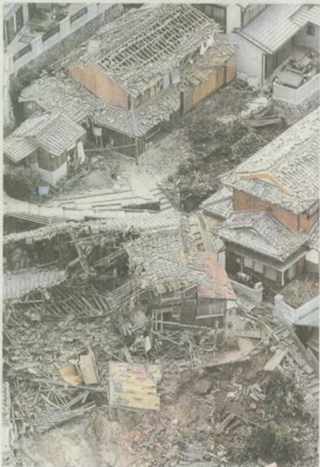
地震で倒壊した家屋。20日午後1時半すぎ、福岡市西の現場
