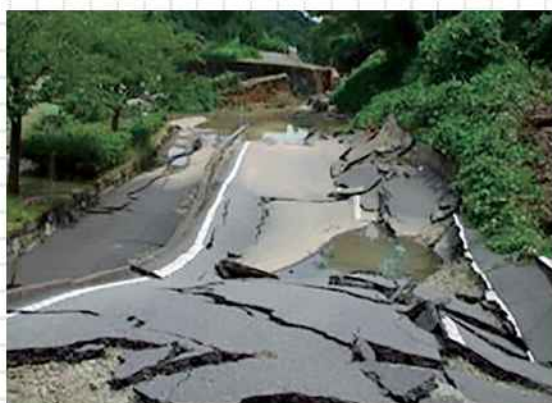
平成21年大雨 武雄市
