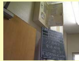
充電保管庫の電源を確保するために新たに分電盤を設置した例
