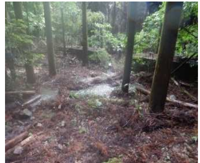
③既設谷止工満砂状況（S51年施工）
