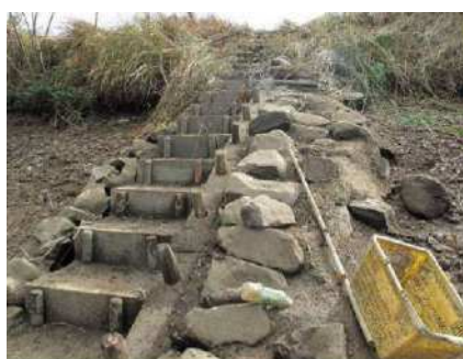
取水施設老朽化状況
