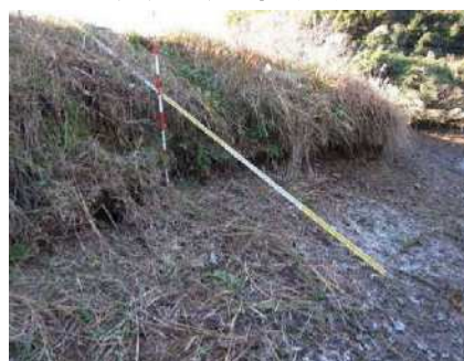
法面洗堀状況
