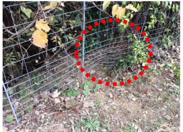
写真 2 内部から押された WM 柵
