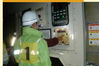
高圧発電機車による電気供給(夜間)
