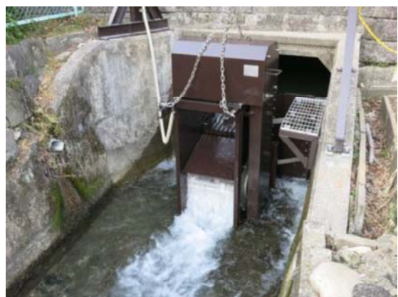
【小水力発電装置】
