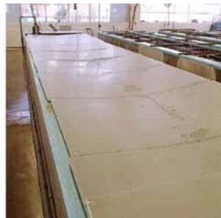
図版7-6 生物濾過槽
