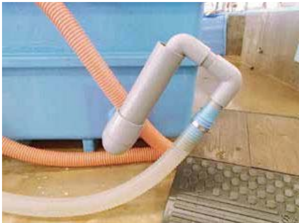
図版7-2 受け水槽側面の二重パイプ
