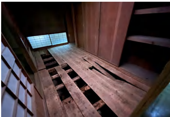
図3-1-28 破損がみられる床板
