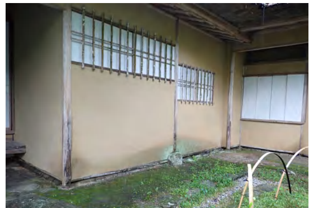
図3-1-29 染みがみられる土壁
