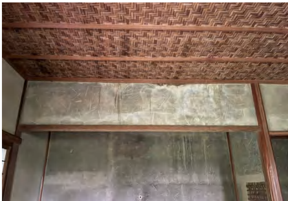
図3-1-26 雨漏りによる染み
