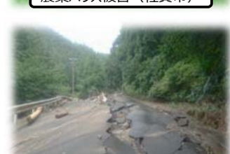
林道被害（基山町）
